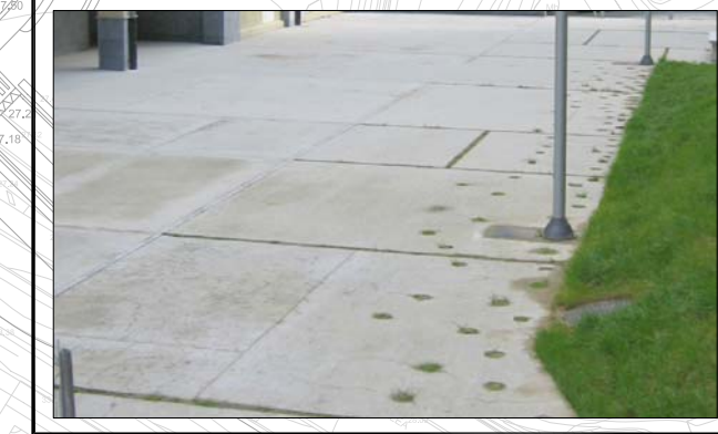
HORMIGON ABUJARDADO CON JUNTA VERDE Y LLANTA
