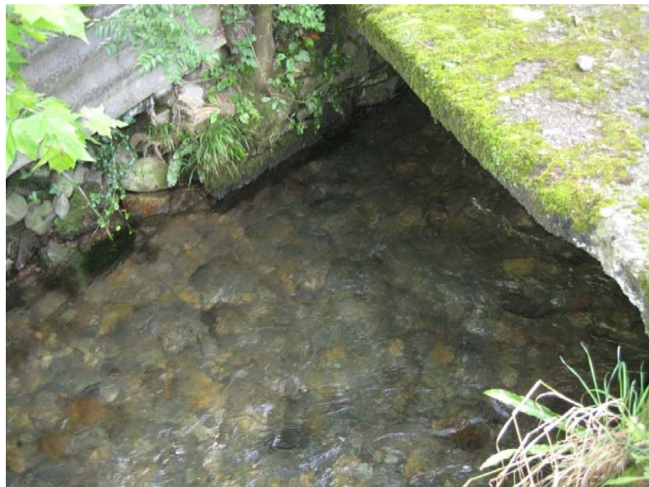
SECCIÓN 38: Cauce compuesto por grava y roca, no tiene irregularidades en el lecho pero sí cambios ocasionales transversalmente. Existen importantes obstrucciones y la vegetación dentro del cauce del río es media.
