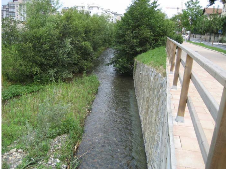
SECCIÓN 15: Cauce compuesto por grava y roca, no tiene irregularidades y tampoco cambios transversales. No existen obstrucciones y la vegetación dentro del cauce del río es media.
