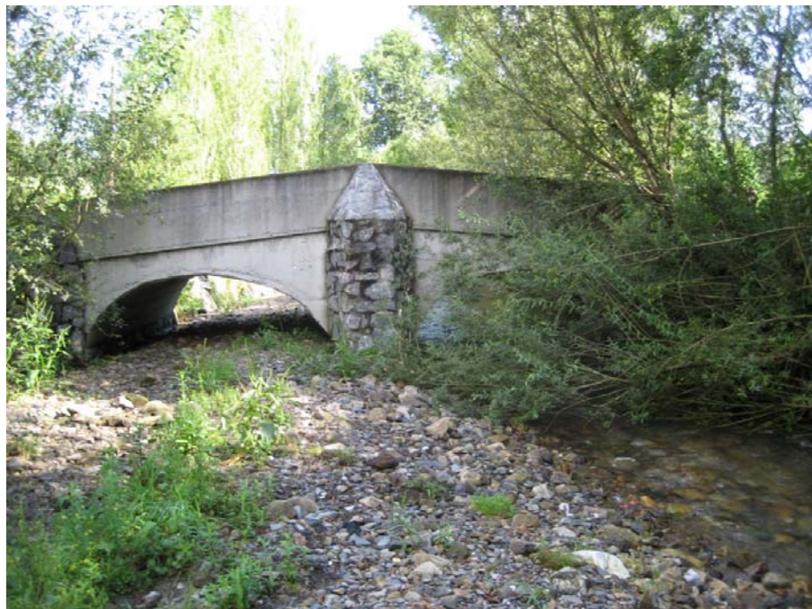
SECCIÓN 42: Cauce compuesto por grava y roca, no tiene irregularidades en el lecho pero sí cambios ocasionales transversalmente. Existen importantes obstrucciones y la vegetación dentro del cauce del río es media.
